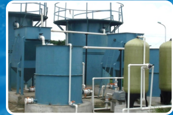
EFFLUENT TREATMENT PLANT(ETP)
